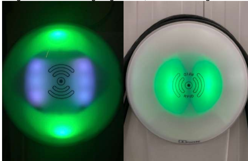
Abbildung 16: Betriebsbereite Ladestation mit einem freien Ladeplatz
